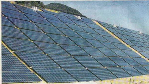
Ein Meer aus Photovoltaikplatten: Ähnlich wie hier in Nivelstein wird es bald auch im Hochfeld aussehen.
